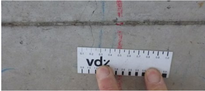
Abbildung 3 Risse in einem Brückenwiderlager. Quelle: VDZ Technology gGmbH
