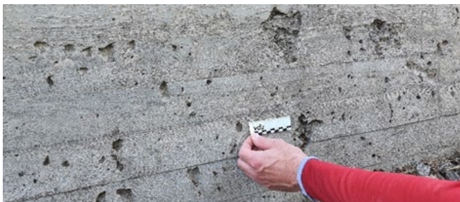
Abbildung 4 Große Poren, Lunker und Kiesnester an einem Brückenbauteil. Quelle: VDZ Technology gGmbH
